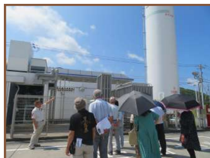
周南市水素ステーション
